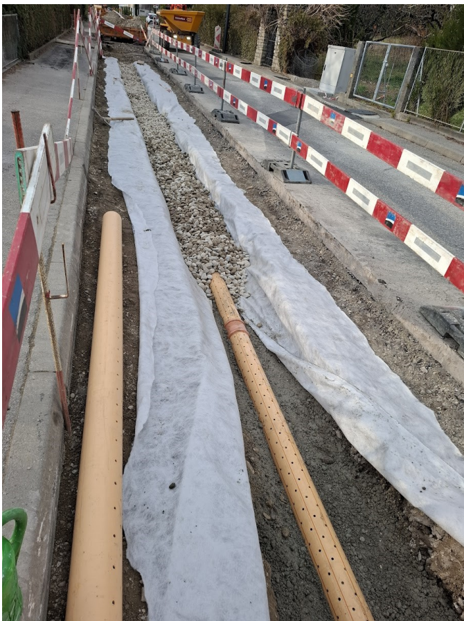
Installation d'un drainage des places de parc, à la route des Cerisiers, pour assurer l'hydratation des fosses d'arbres
